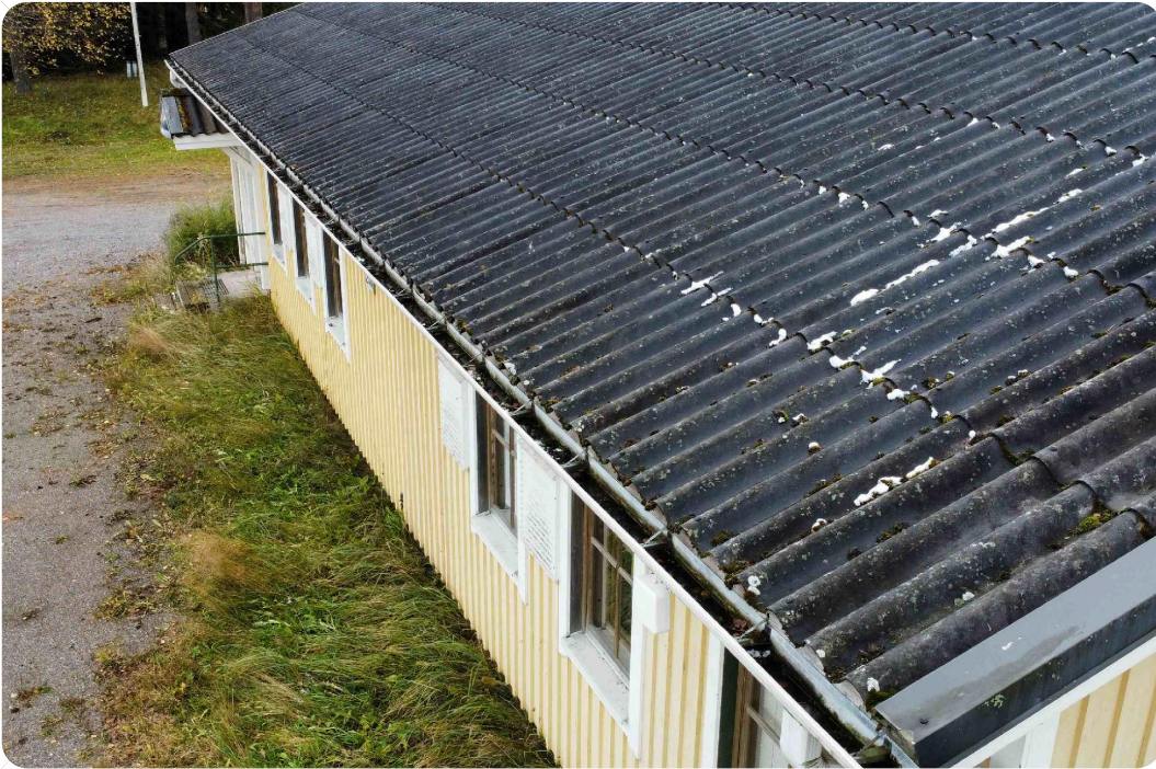
Havainto10 Vesikouruissa havaittiin roskaantumista ja kariketta.
