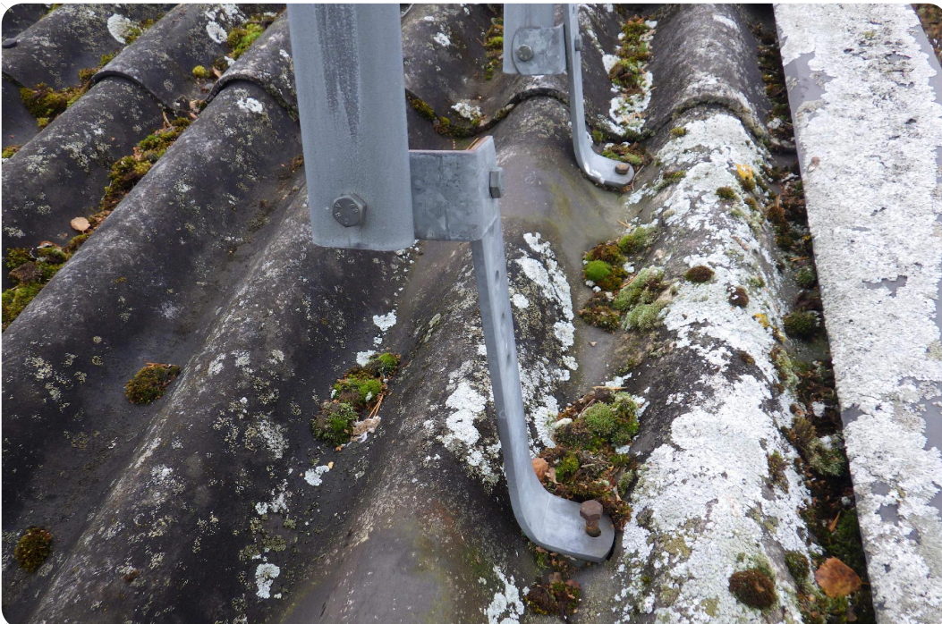
Havainto2 Talotikkaiden yläkaaret ovat läpikiinnitetty katteeseen. Yksi kiinnitys on perääntynyt.
