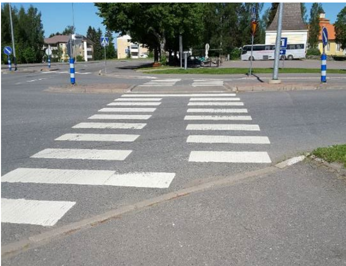
Reunatuet ovat liian korkeat suojatiellä Mutalantien ja Joroistentien liittymässä.
