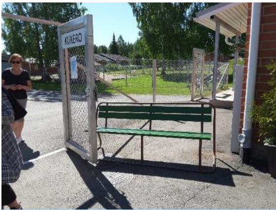
Kukero-päiväkotiin mennessä portilla ei kynnystä, mutta penkin vuoksi ovi ei kunnolla avaudu.
