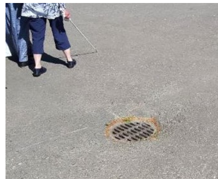
Kaivonkansi on kuopalla torilla (kompastumisvaara).
