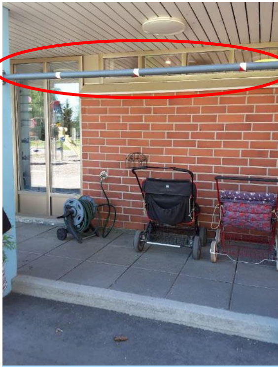
Tanko vaunujen säilytyspaikan edessä aiheuttaa törmäysvaaran.
