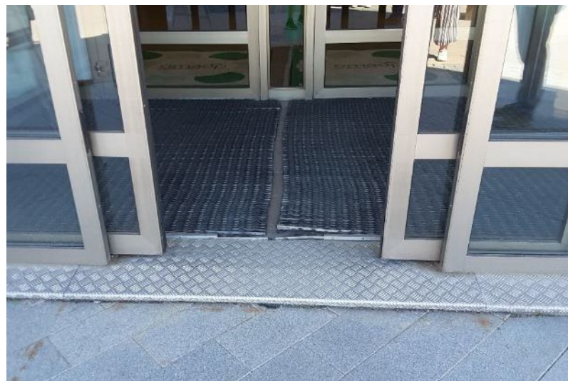
Pankin sisäänkäynnin edustalla on kynnys ja jyrkähkö luiska. Tuulikaapissa oleva matto aiheuttaa lisää estettä.
