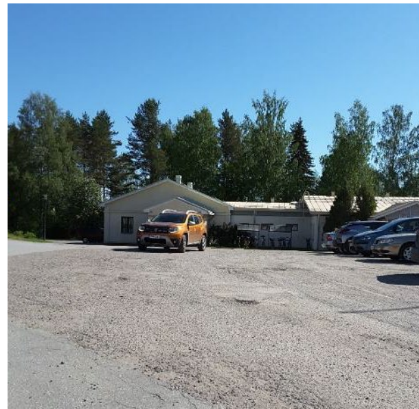
Terveyskeskuksen piha-alue on huonossa kunnossa.
