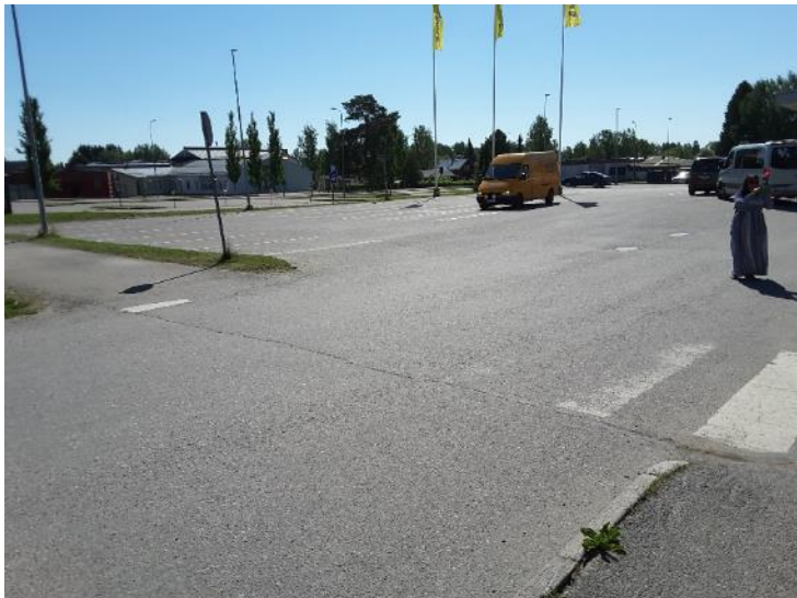
Kaupan liittymän läheisen suojatien maalaukset ovat kuluneet ja reunatuki puuttuu.
