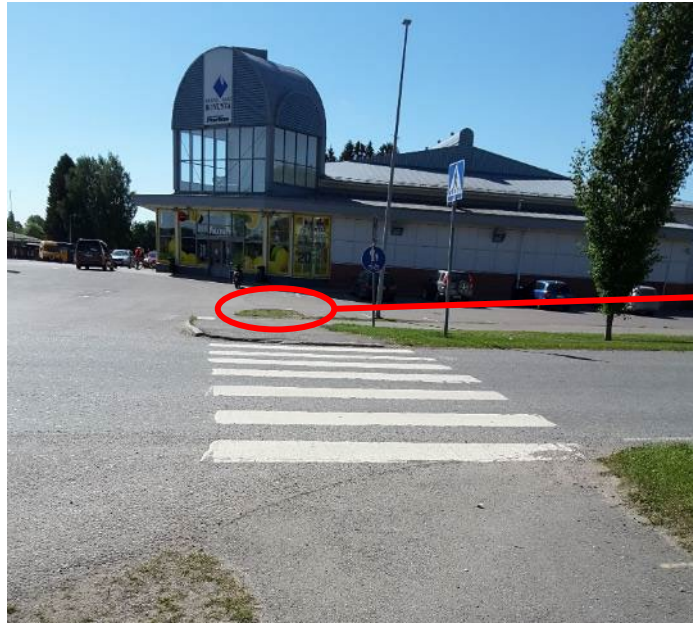
S-marketin kohdalla suojatiellä reunatuki on liian jyrkkä ja osittain rikki, toisesta reunasta puuttuu kokonaan.
