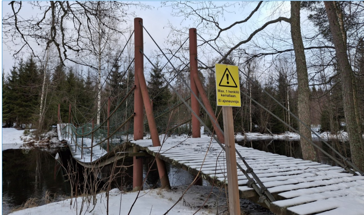
Huutokosken kevyen liikenteen riippusilta helmikuussa 2025. Henkilörajoitusta suositeltiin 2023 tehdyssä yleistarkastuksessa.
