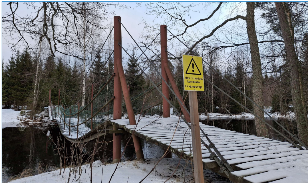
Huutokosken kevyen liikenteen riippusilta helmikuussa 2025. Henkilörajoitusta suositeltiin 2023 tehdystä yleistarkastuksesta.
