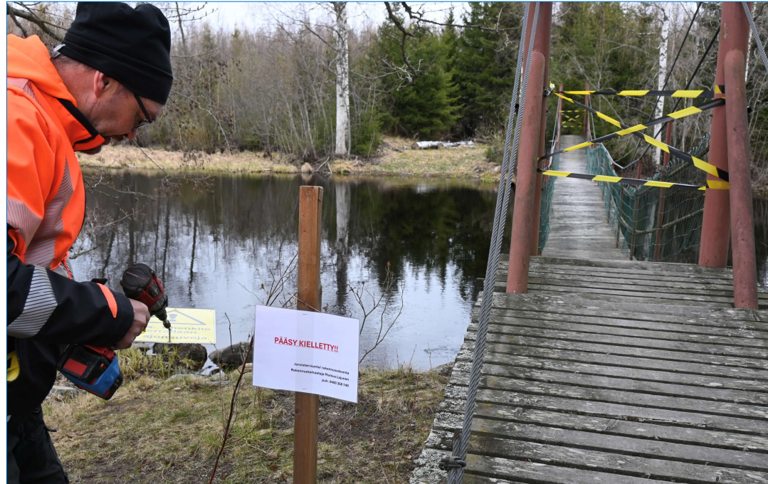
Joroisten kunnan teknisen toimen työntekijä sulki Jokitien päästä lähtevän kevyen liikenteen riippusillan 8.5.2025. Päätöksen sulkemisesta teki sillan vuoden 2023 yleistarkastuksen pohjalta Joroisten kunnan rakennusvalvonta. Kuva: Kari Suhonen
